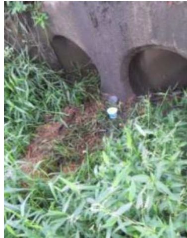
Figura 14: Canalização obstruída sob rodovia.
