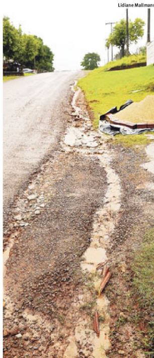
CEDRO: água se acumula em dias de chuva na Rua Eleolino Domingos Zagonel
