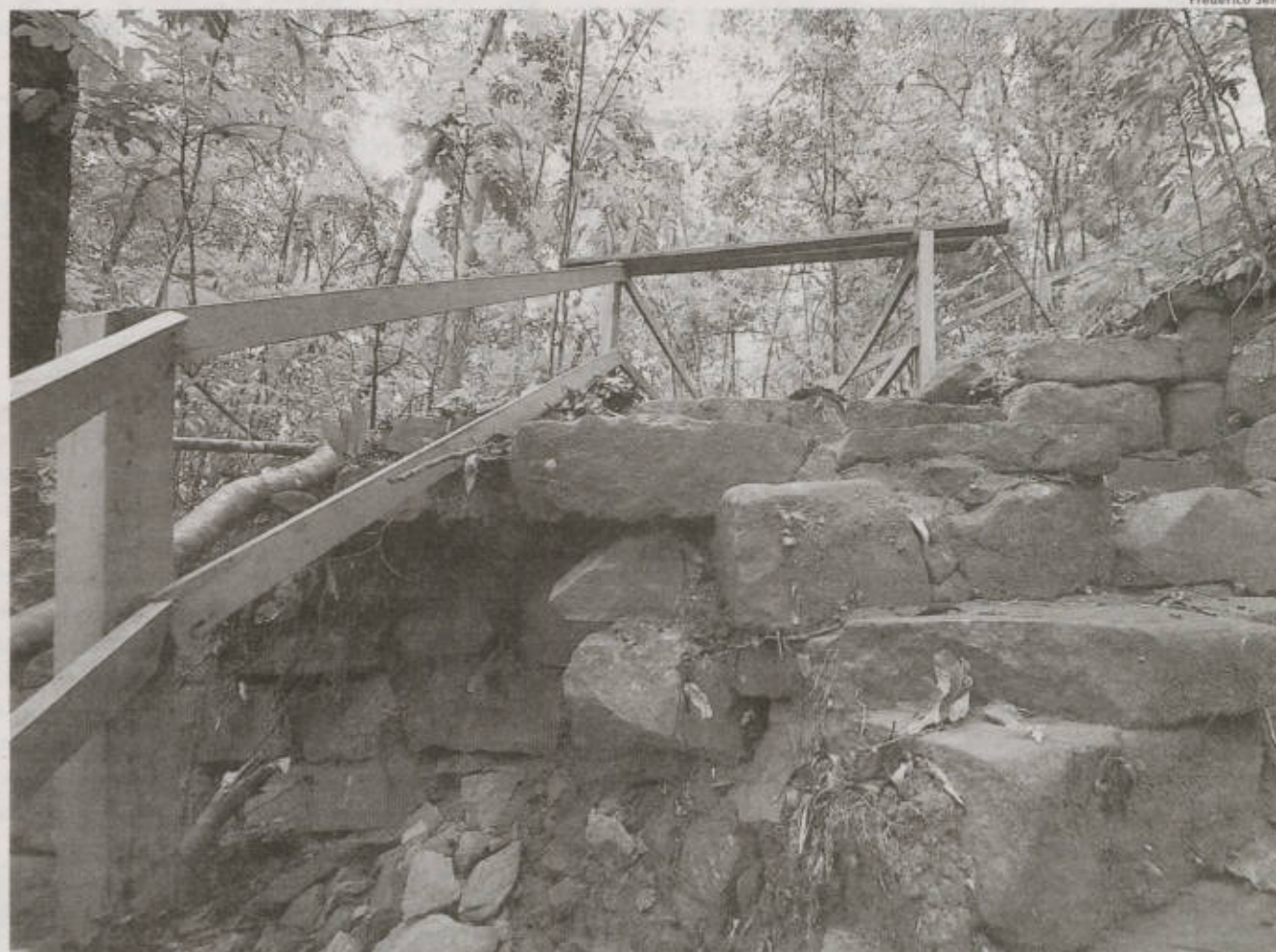
Escadarias estão com degraus e corrimãos danificados
