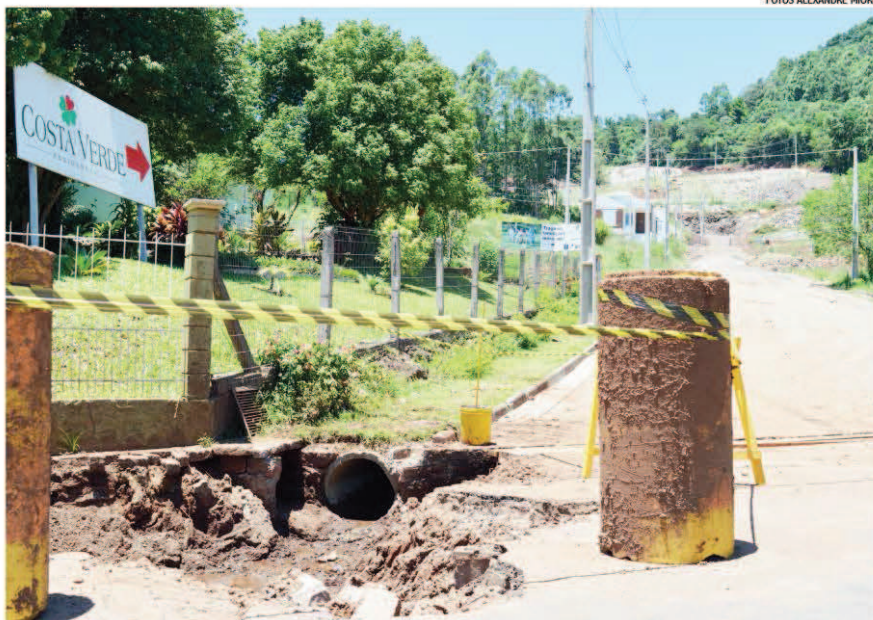
Entupimento de cano fez transbordar sistema pluvial próximo à construção do Condomínio Costa Verde
