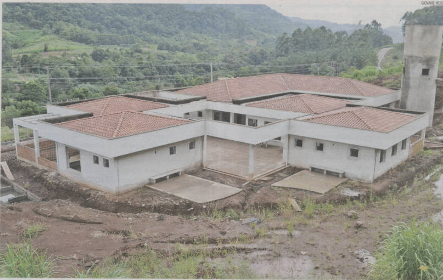
Prédio com mais de 500 metros quadrados foi projetado para atender até 120 crianças. Localizado na encosta de um morro, precisou de aditivos e encareceu. Município abriu valetas ao redor da estrutura para impedir que a água continue entrando nas salas
