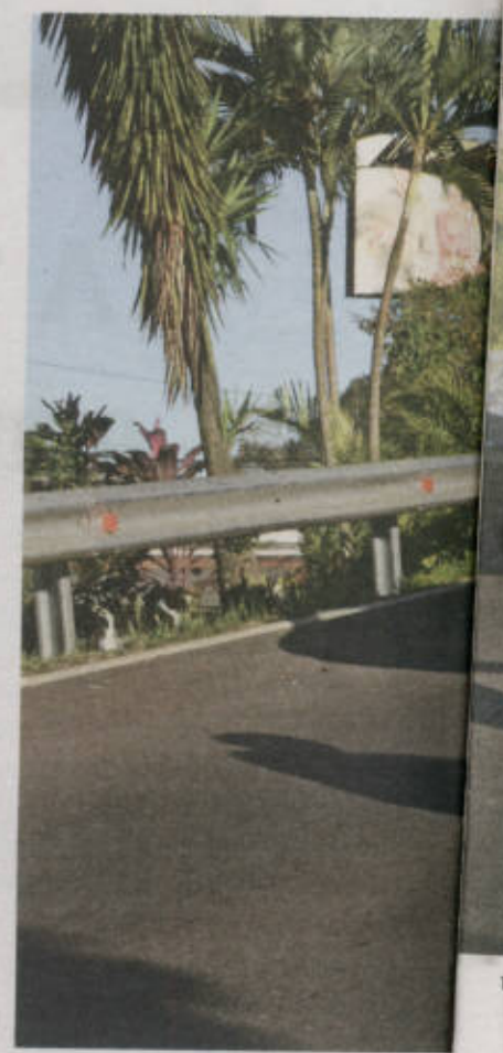
PERIGO: falta de infraestrutura dificulta
