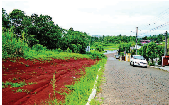
Moradores reclamam de obra paralisada na Rua Nicolau Araújo Junges
