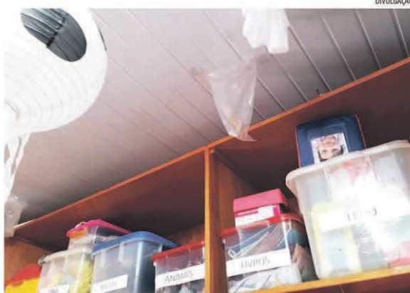
Sacolas são usadas para segurar a água que entra pelas paredes
