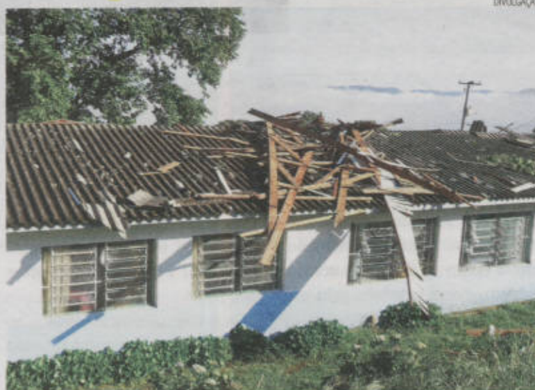
Aulas na escola Ouro Preto estão suspensas devido à queda do telhado
