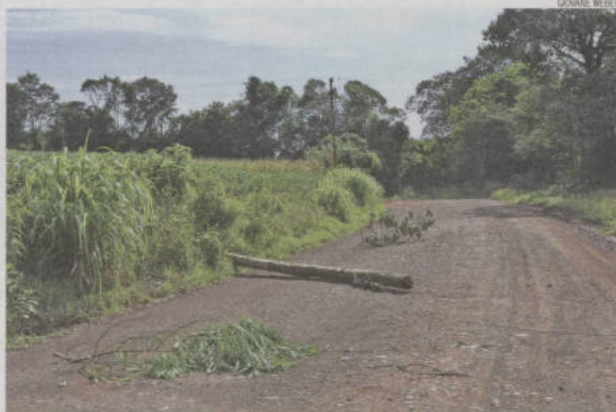
Antigos e podres, postes de madeira lideram as queixas contra a concessionária AES Sul
