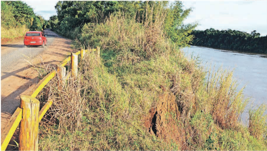
Na ERS-129, promotoria verificou desbarrancamento de talude do Rio Taquari junto ao corredor ecológico
