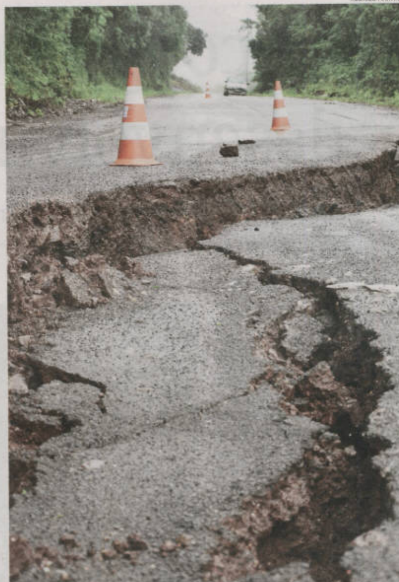
Westfália: estrada na localidade de linha Paisandu cedeu com a enxurrada
