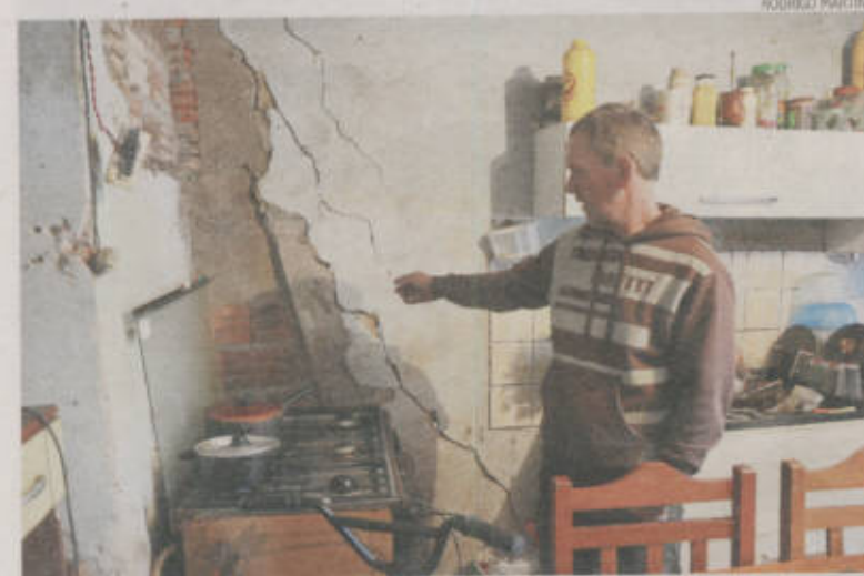
Arroio do Meio: rachaduras na casa de Guido Friedrich denunciavam o risco...
