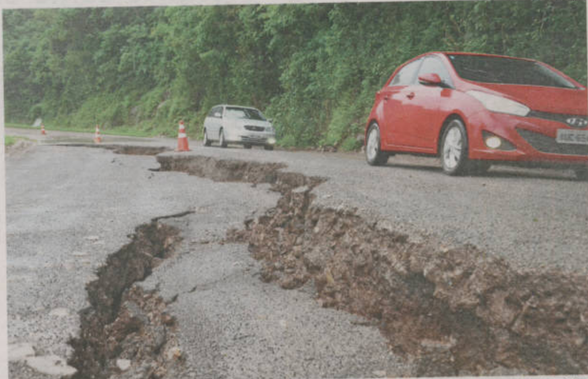
CALAMIDADE: excesso de chuva provocou queda de barreiras e destruiu estradas, como no interior de Westfália
