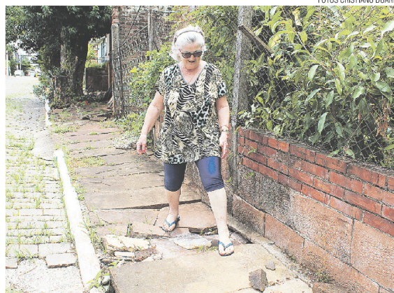
“É um tanto perigoso caminhar nessas calçadas irregulares”, diz Clarise Cardoso, moradora da Rua Dr. Albert Schweitzer, no Bairro São Cristóvão
