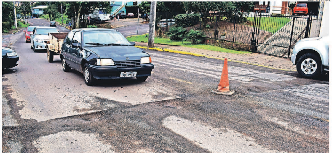
Buracos deixados após obras da Corsan incomodam motoristas. Na rua Carlos Spohr Filho, moradores chegaram a fechá-los com terra
