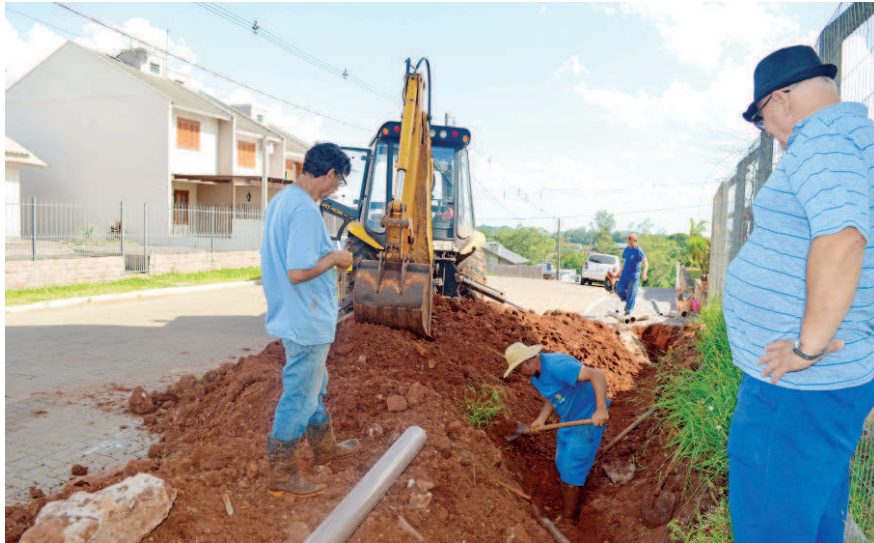
Equipe trabalhou nas proximidades de reservatórios para solucionar problema. Suspeita é de vazamento na tubulação
