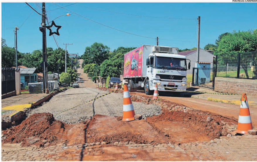
Buracos da rua Ermino Lohmann, a principal do bairro, estão entre as principais reclamações da comunidade
