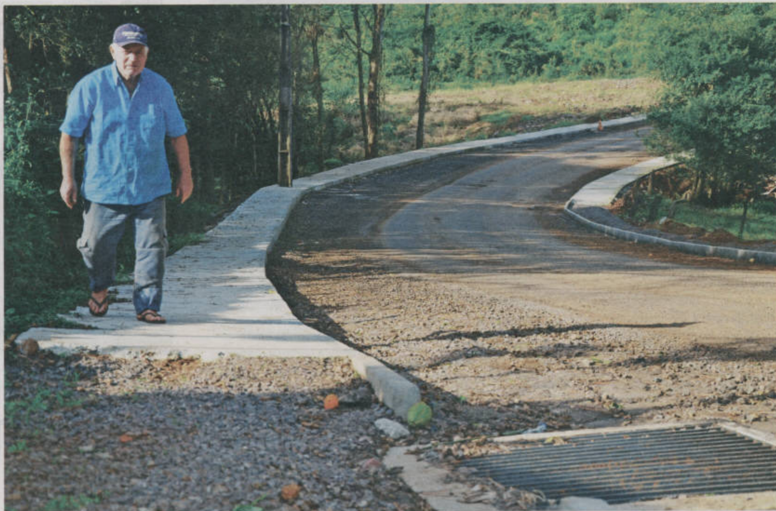
Na rua Pedro Petry, calçada está incompleta e buracos surgem na via. Lá, MPF aponta mais de R$ 20 mil de cobrança indevida com "transporte de material escavado"
