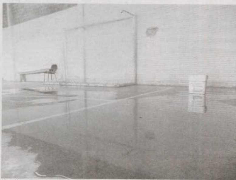
Goteiras comprometem o piso, que permanece alagado e interditado para jogos
