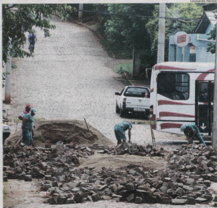
Obras são constantes na Rua da Divisa. No entanto, problemas persistem
