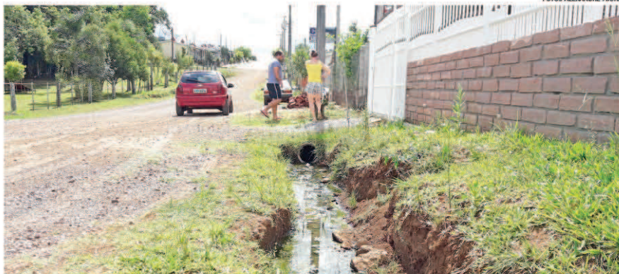
Fossas abertas em frente a casas recebem esgoto cloacal de centenas de moradores no Loteamento 8
