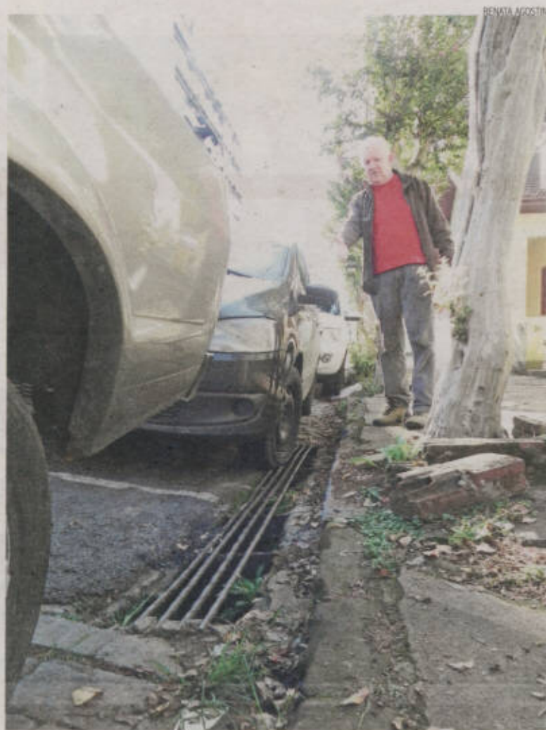
Falta de manutenção em bocas de lobo e demora na capina são reclamações
