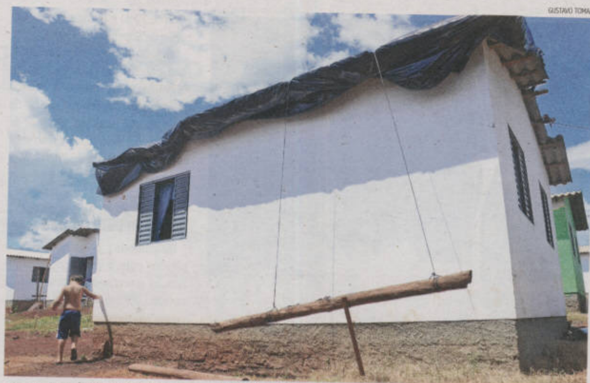
Na casa de Marta a lona improvisada como telhado furou com a chuva. Residências foram entregues em agosto de 2013
