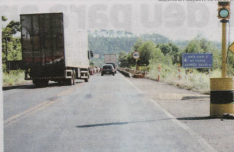
Dnit contratará serviços para solucionar problema num dos cabos de aço
