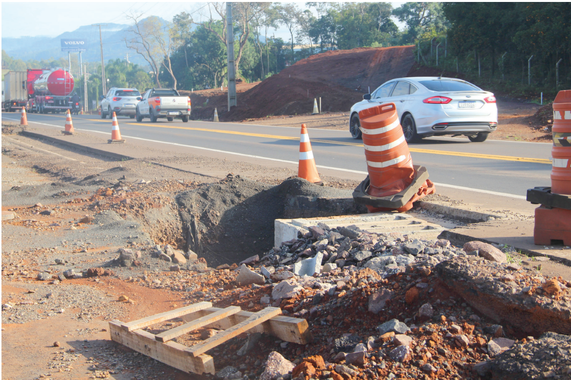
Trecho em direção a Marques de Souza apresenta locais em que a sinalização cedeu e a drenagem não foi concluída
