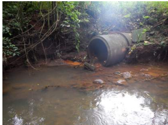
102: Canalização proveniente do bairro
