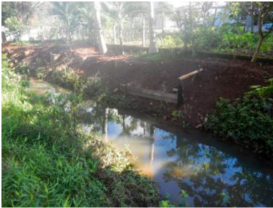
Figura 83: Margem aterrada recentemente e canos de PVC aparentes
