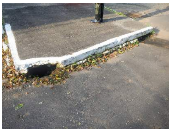
Figura 124: Bueiros de esgoto pluvial interligados com a canalização do arroio.
