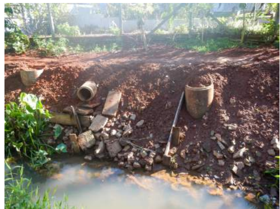
Figura 84: Margem aterrada recentemente e canos de concreto aparentes
