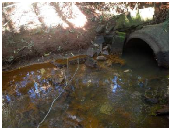
Figura 56: Chegada dos tubos do arroio do Engenho e demais contribuições
