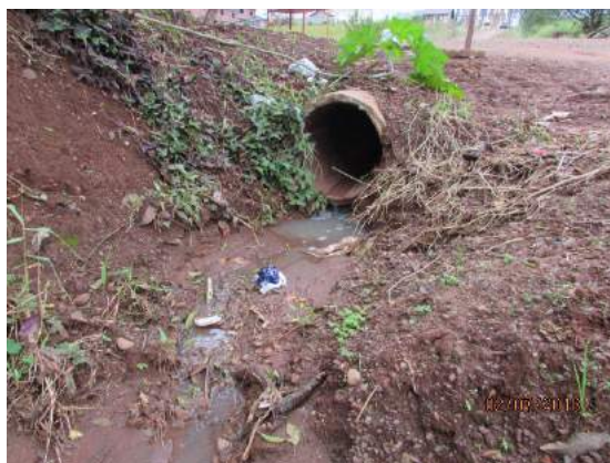
Figura 12: Efluentes residenciais sendo despejados na vala de drenagem pluvial
