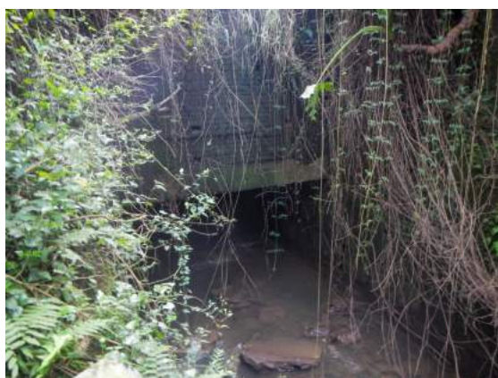
Figura 129: Canalização sem tampo superior
