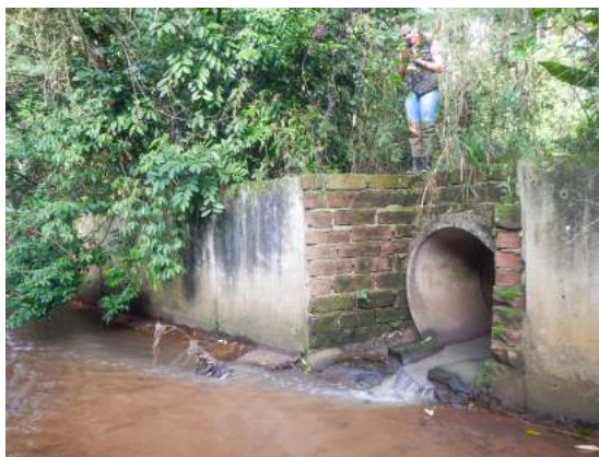
Figura 95: Canalização com contribuição de esgoto doméstico
