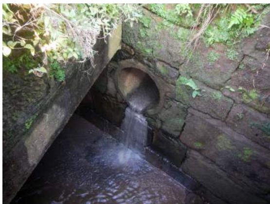
Figura 127: Diminuição da altura da canalização do Arroio e entrada de efluentes
