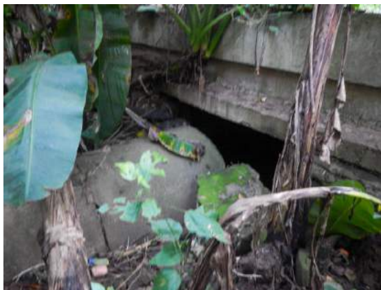
Figura 123: Entrada de efluentes na canalização do Arroio.
