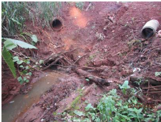
Figura 24: No alto da imagem, duas tubulações de entrada no arroio e abaixo o leito e o recomeço da canalização
