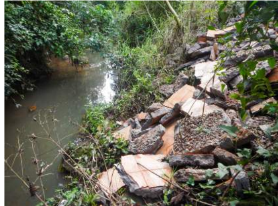
Figura 72: RSCC na margem do arroio
