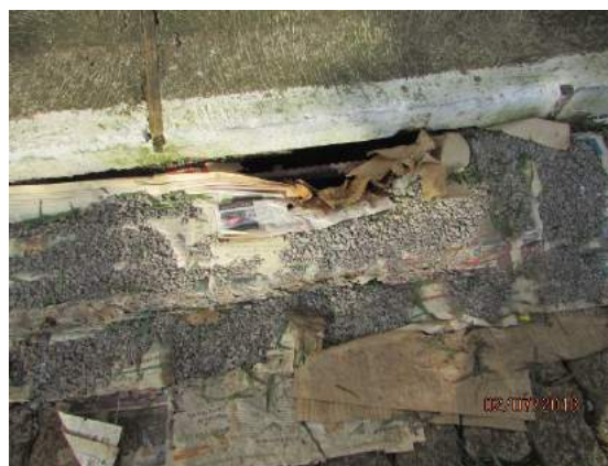
Figura 5: Fechamento dos bueiros pela população
