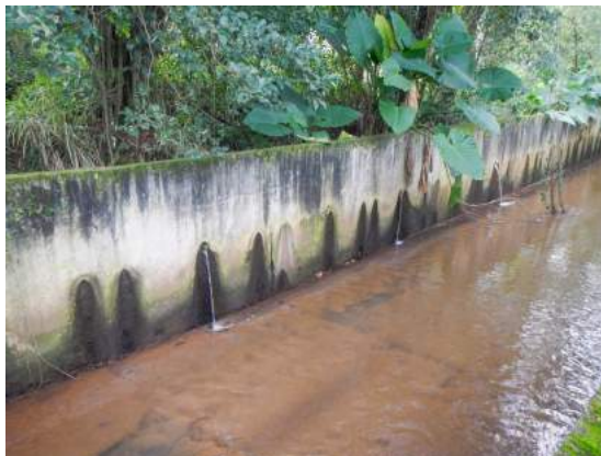
Figura 94: Contribuições na parede do canal
