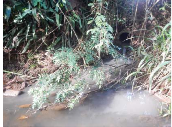
Figura 74: Entrada de esgoto junto a canalização pluvial da rua
