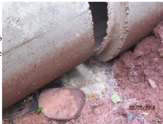
Figura 26: Detalhe para característica do efluente que entra no arroio
