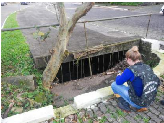
Figura 125: Pequena abertura no tampo da canalização do Arroio
