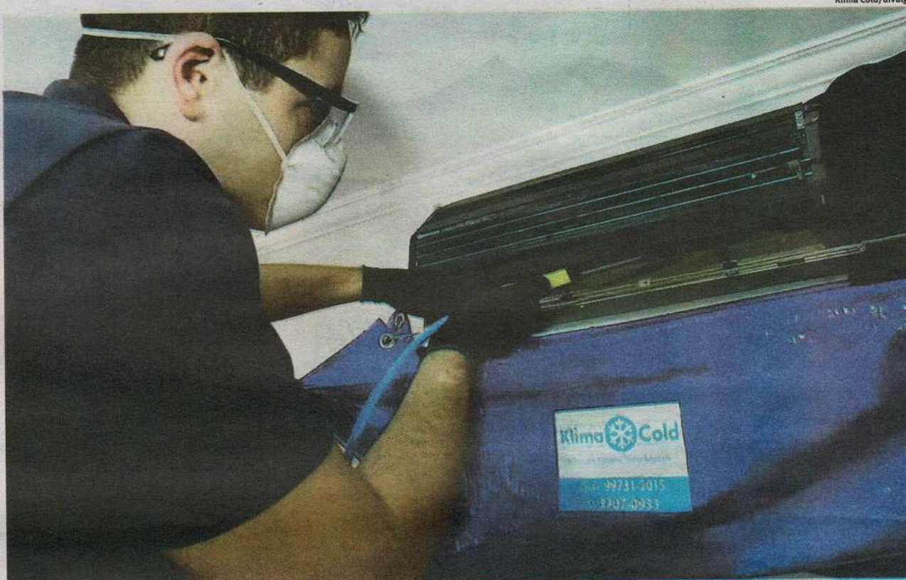
CONSERVAÇÃO: equipe da Klima Cold realiza limpeza, que também ajuda a reduzir consumo de energia
