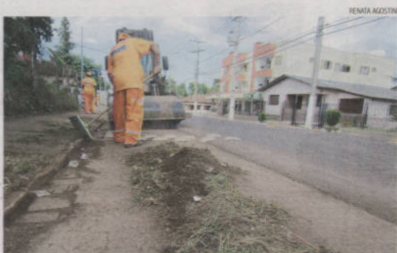
Serviço de capina volta a ser feito após interrompido por mais de dois meses
