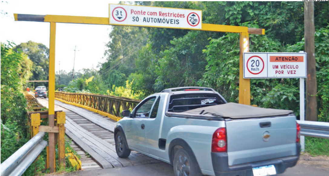
Só um veículo por vez passa na ponte de acesso ao Boa União. Estrutura pode ser interditada pelo município
