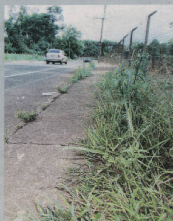
Em um trecho da Avenida Beira Rio, no Bairro Santo Antônio, mato toma conta da calçada
