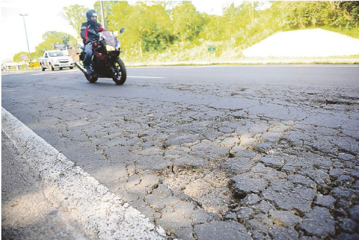
ESTRADA: buracos pioraram com as chuvas e prejudicam motoristas
