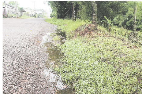
Água de esgoto é realidade da Rua Miguel Paulos no Bairro Planalto
