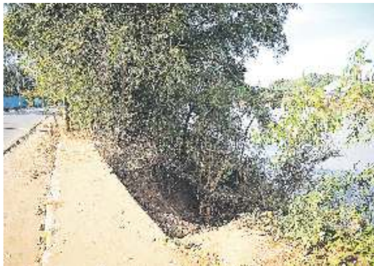
Deslizamento chegou até a calçada de passeio
