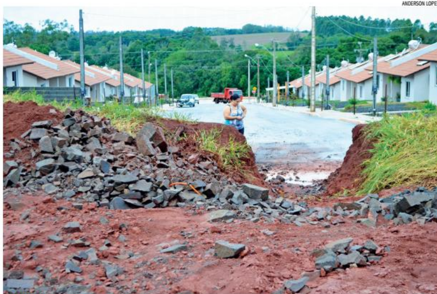
ESTRELA: contenção no Nova Morada não suportou força da água. O barro invadiu diversas casas do complexo
