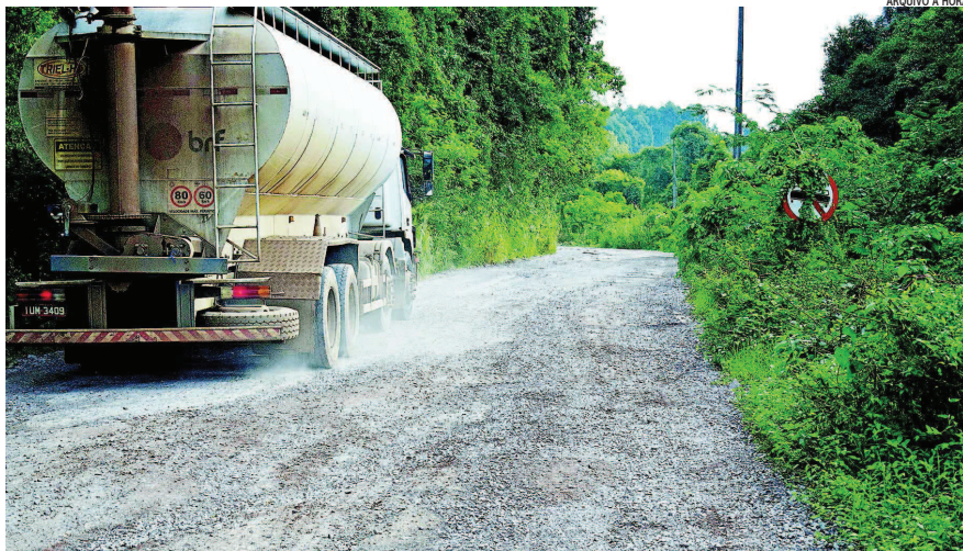
Problema antigo na ERS-423, em Progresso, deverá ser solucionado com liberação de R$ 1 milhão
