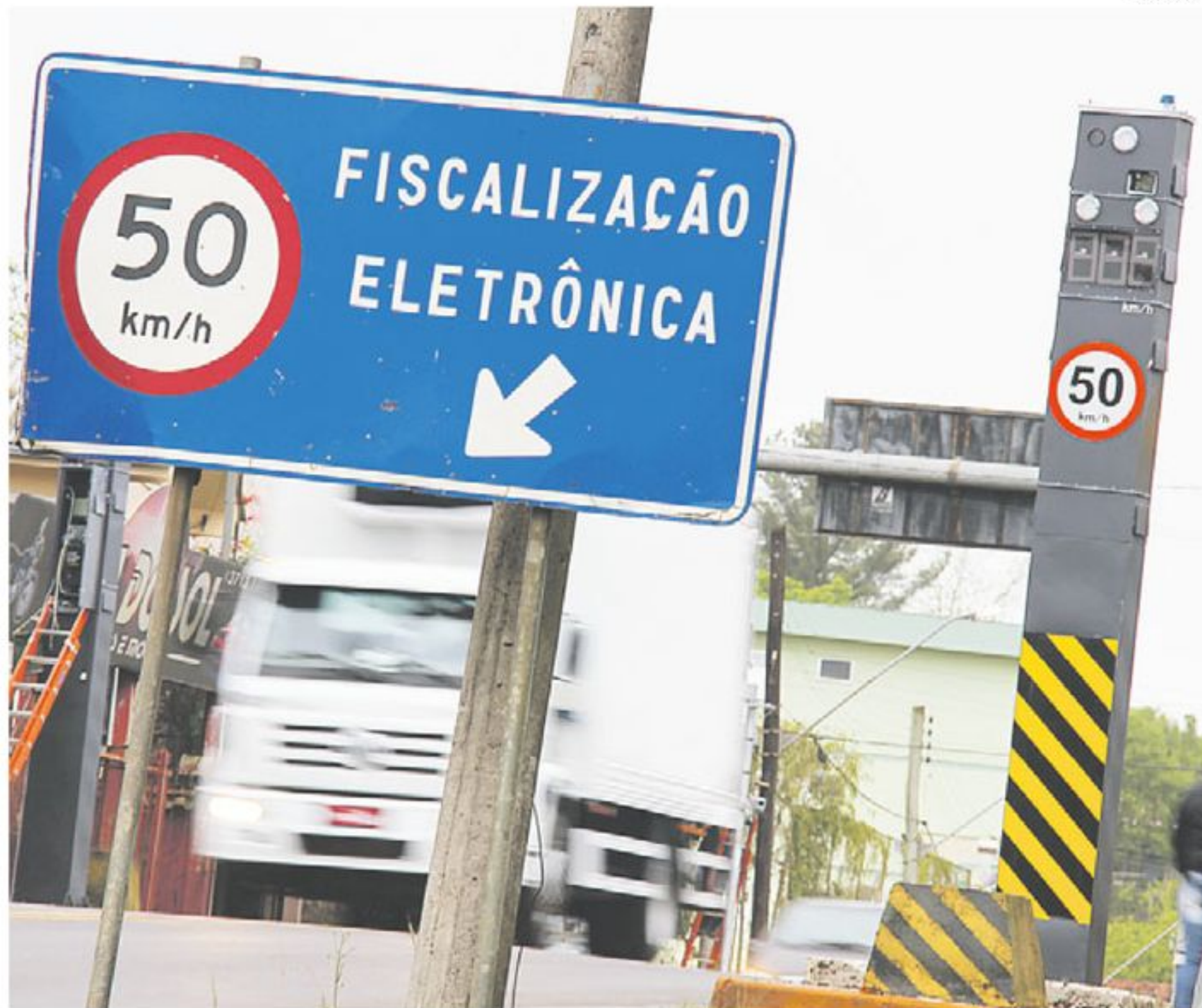
FALTA A LIGAÇÃO ELÉTRICA: lombadas já estão instaladas nos dois pontos
