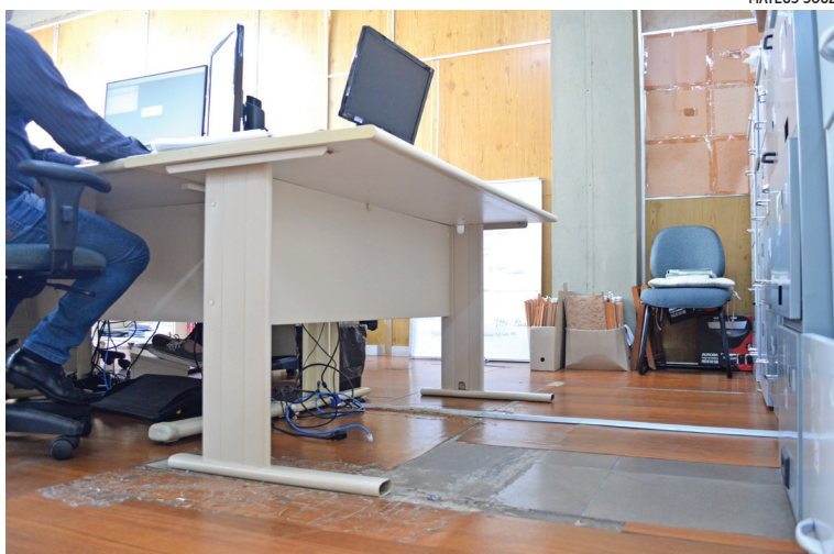
Problemas de infraestrutura são evidentes na parte interna do prédio
