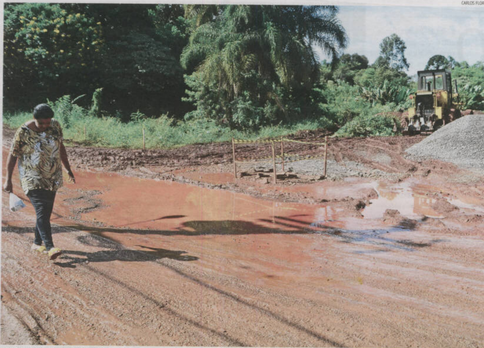
Governo alega que pavimentações do PAC não estão paradas. Moradores do Jardim do Cedro afirmam que nenhum trabalho foi realizado nos últimos meses
