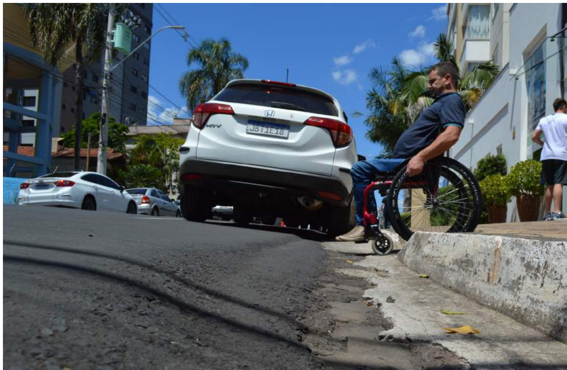
Desnível entre pavimentos é questionado por vereador e dificulta locomoção de cadeirantes
