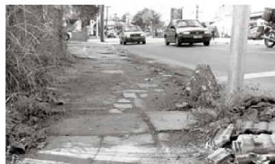
SUJEIRA: telhas quebradas e barro dificultam a passagem no Bairro Florestal
