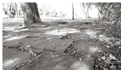
LIMO: lajes escorregadias oferecem risco de queda
