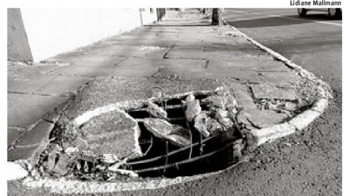
PERIGO: boca de lobo aberta coloca pedestres em risco
