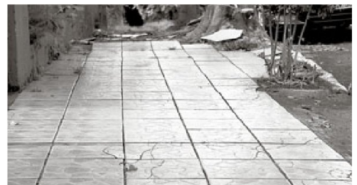
LAJOTA: pisos escorregadios oferecem risco de queda
