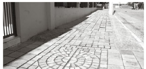
EM DIA: residência no Bairro São Cristóvão dá exemplo de passeio público em condições
