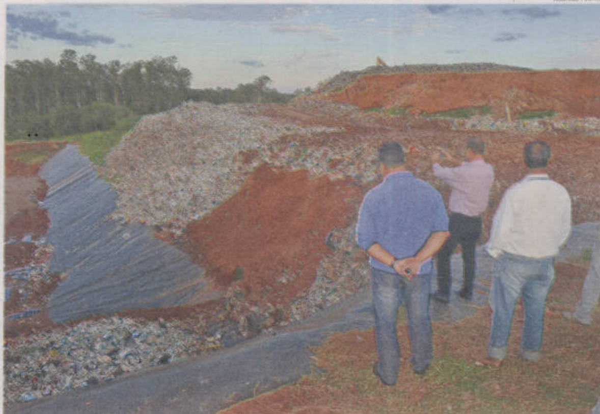
Cerca de 55 toneladas de lixo são depositadas em locais impróprios todos os dias no aterro sanitário. Fepam deve vistoriar o local
