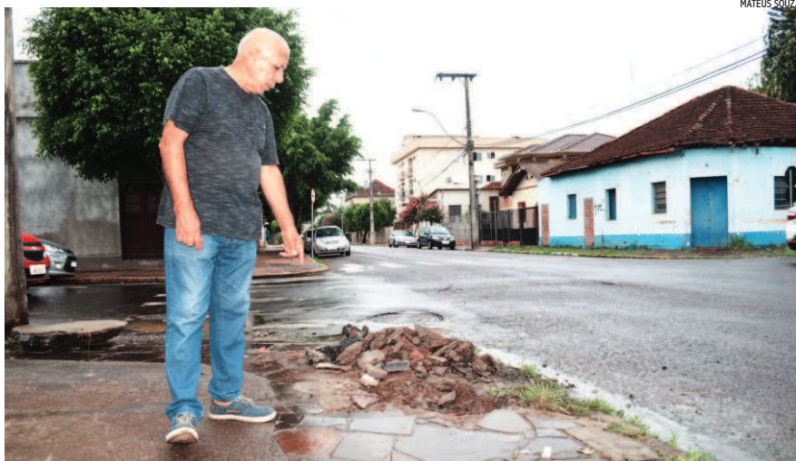
Gomes mostra o local onde esgoto corre a céu aberto, trazendo mau cheiro e transtornos para moradores
