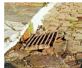
Bueiros danificados causam mau cheiro no Centro
