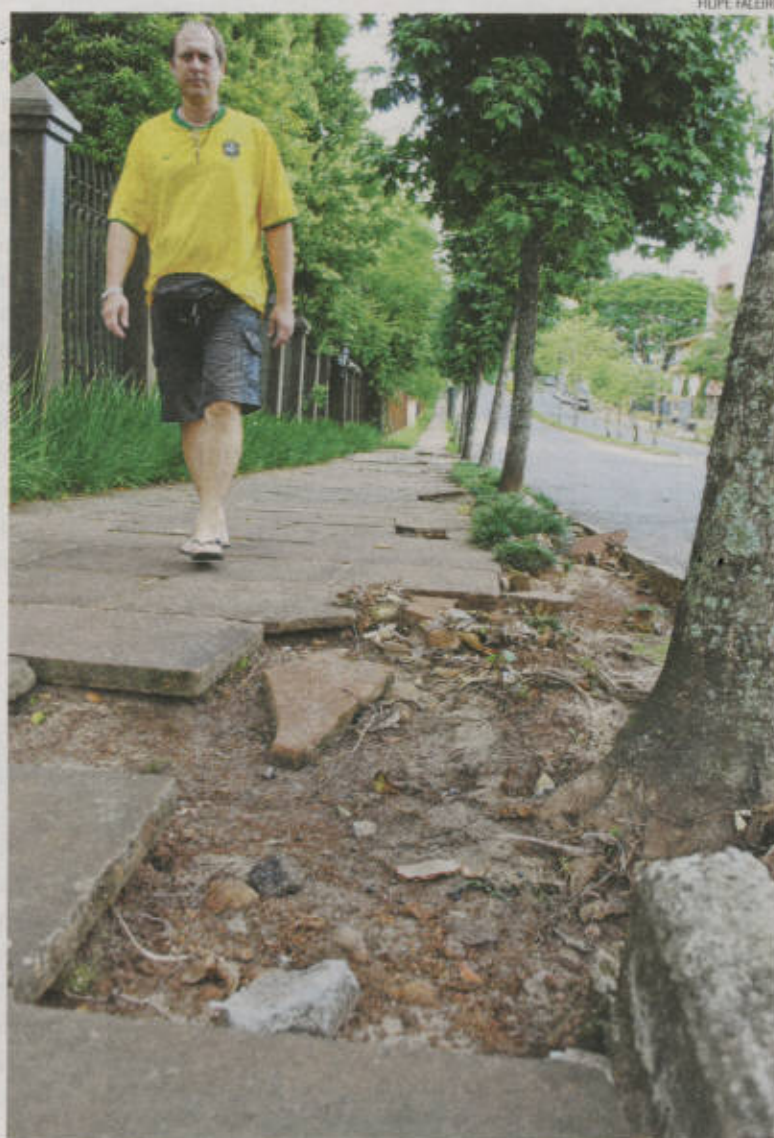
Na Av. 7 de Setembro, pedras soltas, buracos e desníveis dificultam a passagem
