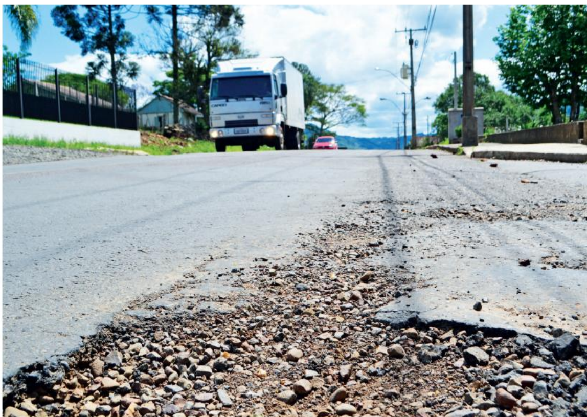
Próximo à empresa Moamar, entrada do bairro Olarias – Lajeado, buraco abriu na pista após a chuvarada e aumenta o risco de acidentes
