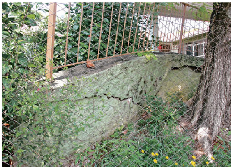
ÁRVORE: crescimento danifica muro, que vai ser retirado. Espaço vai ter ajardinamento
