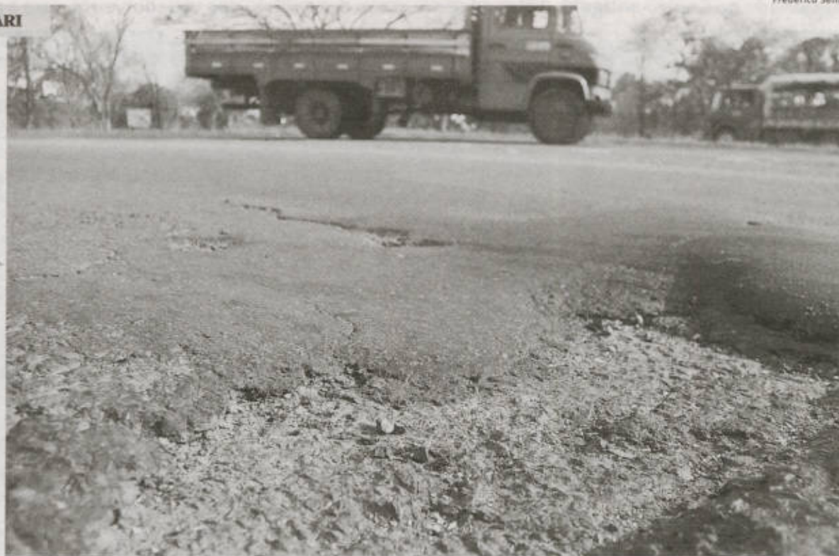
Buracos nas estradas já são comuns nas rodovias da região
