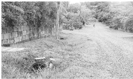
Rua José Inácio Kreutz não tem esgotamento sanitário em toda sua extensão
