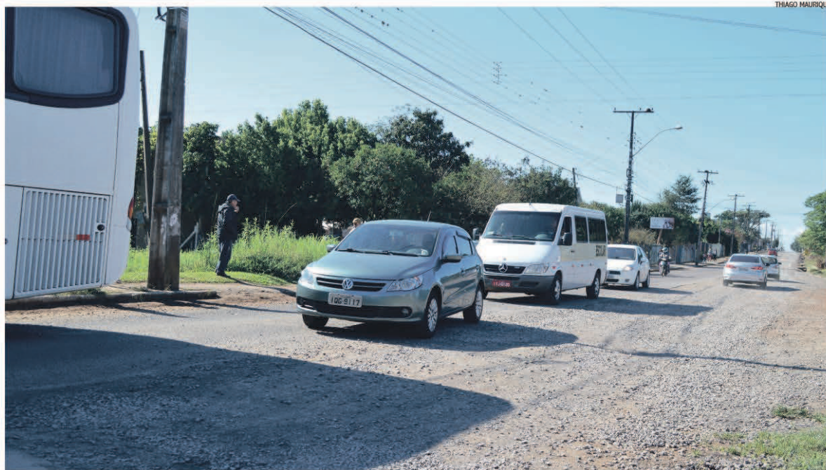
No bairro Conventos, em Lajeado, motoristas convivem faz quatro meses com trecho da ERS-421 de onde foi retirada a camada asfáltica
