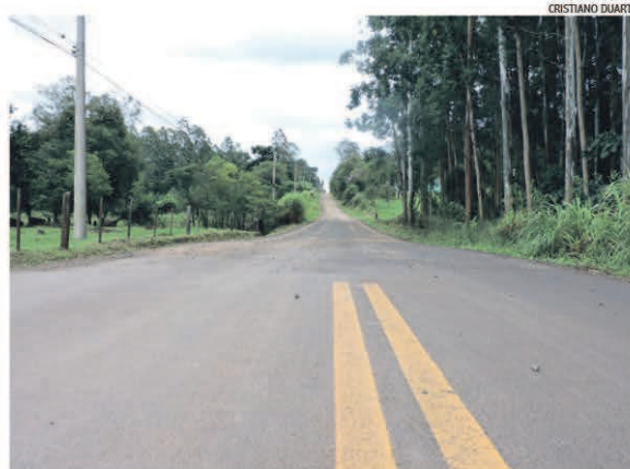
Falta de asfaltamento em todo trecho da Linha Geralda provoca impasse
