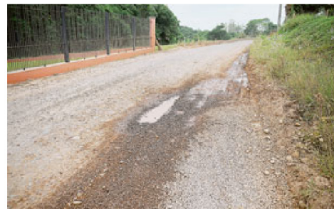
BURACOS: estradas estão com más condições
