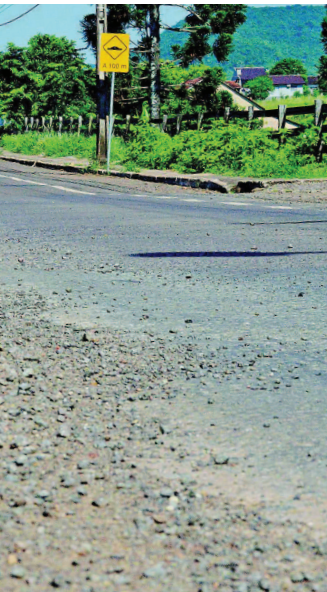
apresenta desníveis, buracos e panelões
