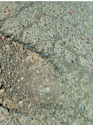
é principal causa de buracos no trecho
