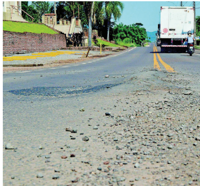
Depois de 6 meses do último recapeamento asfáltico feito pelo Daer, trecho já
