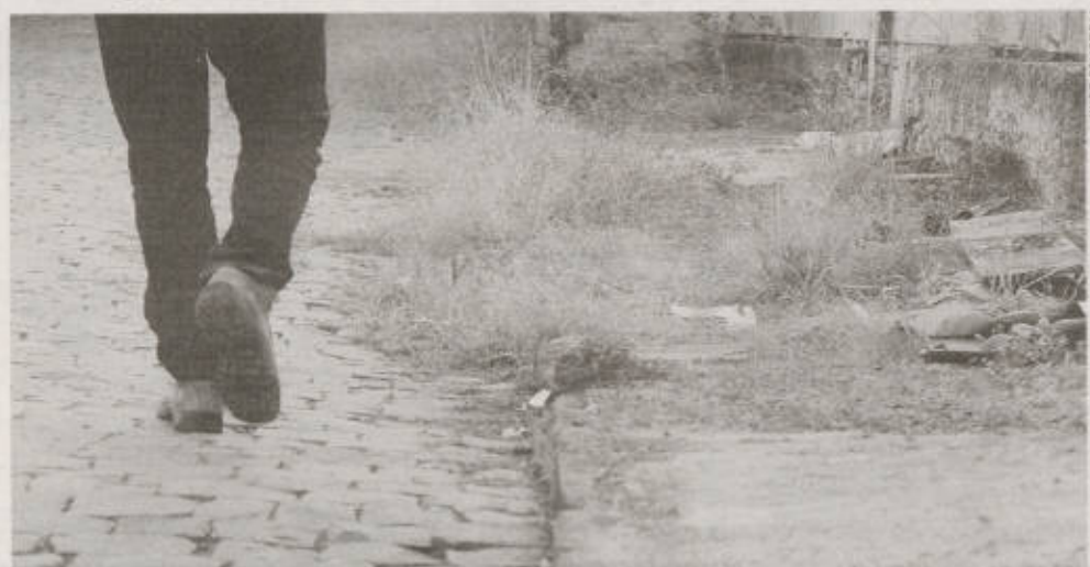
Proprietários que ainda não reformaram suas calçadas serão convocados a adequá-las.
